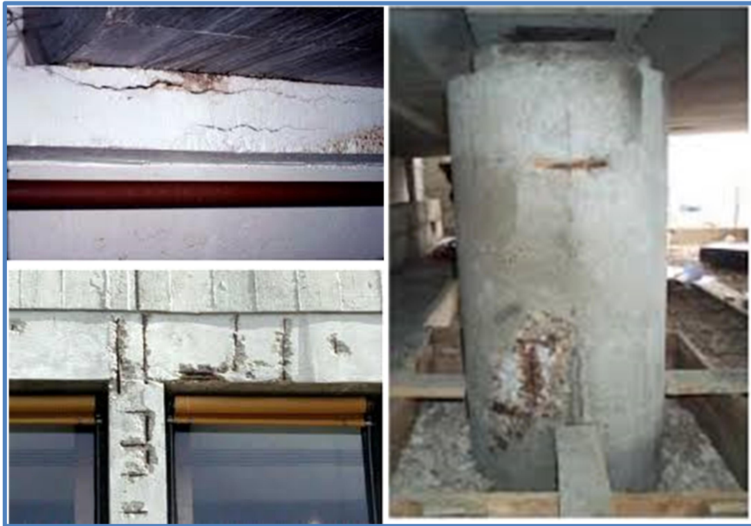
Figure (III.01): Différents types de dégradations [33].
