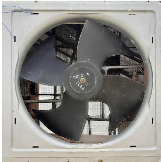
Figure III. 7. Photographie de ventilateur
