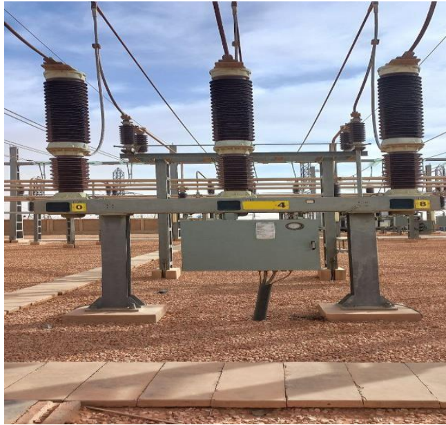
Figure II.8 : Photo d'un disjoncteurs HT à SF6.
