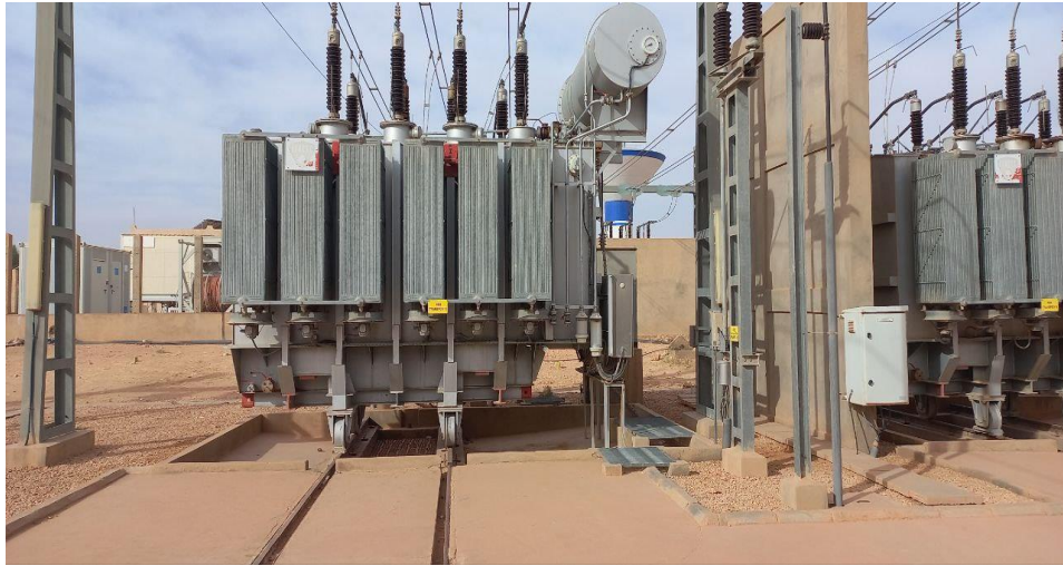
Figure II.5 : photo du transformateur de puissance 60/30kV N°1 du post GHARDAIA.
