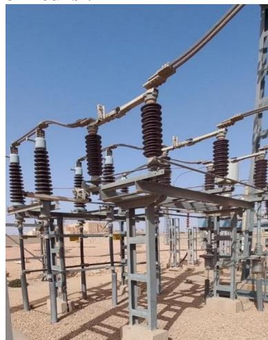
Figure II.9 : Sectionneur tête de ligne et de mise à la terre (malt).
