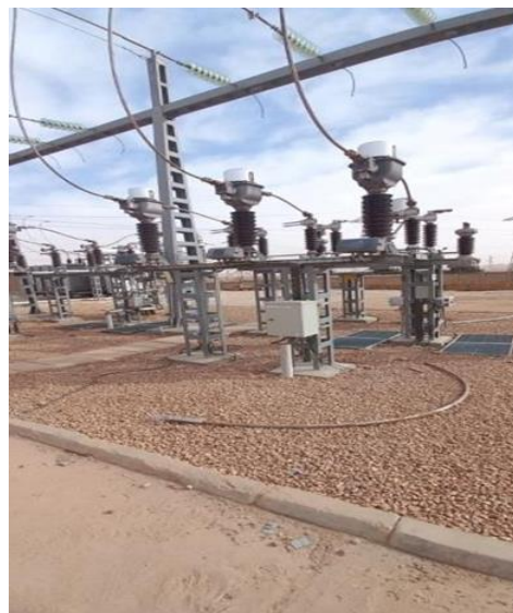
Figure II.6 : Photo d'un transformateur de courant TC.
