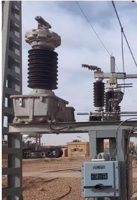
Figure II.7 : Photo d'un transformateur tension (TT ou TP)
