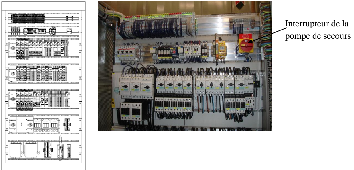
Figure I. 7 : la partie supérieure de l'armoire de distribution 400 VAC
