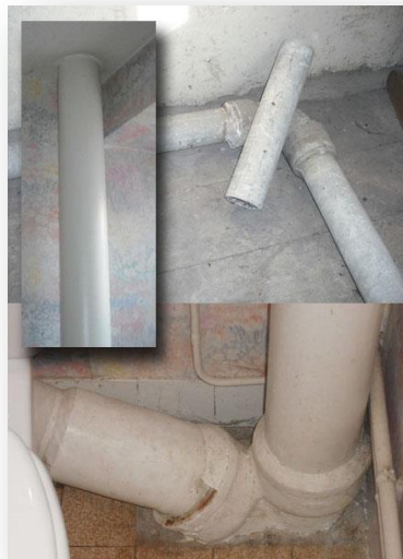
Figure 10 : CONDUITE EN AMIANTE CIMENT
