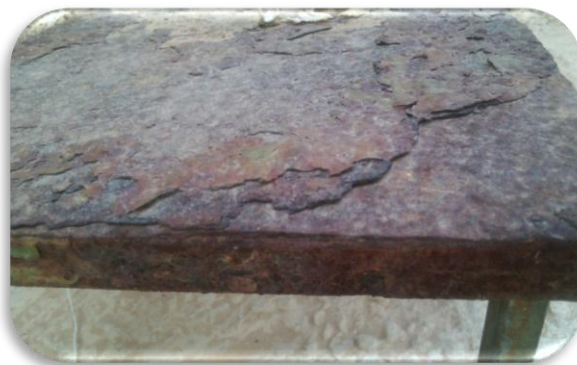
Figure N°12 : Types de corrosion sélective [30].
