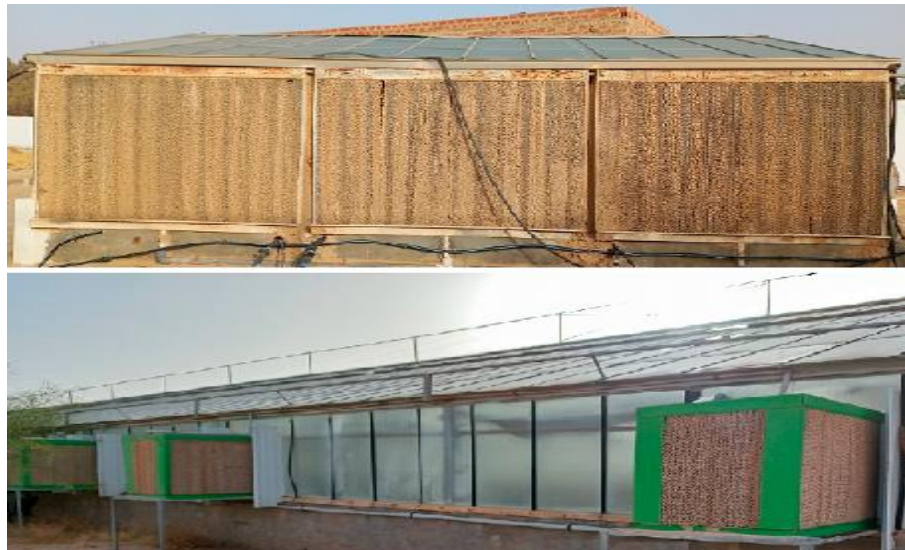
Figure I-7: Système de refroidissement par évaporation PAD (Kébili, Tunisie)
