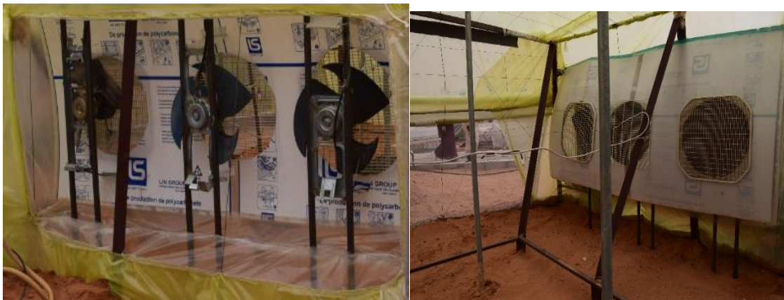
Figure III. 10:ventilateurs à vitesse variable, contrôlés manuellement
