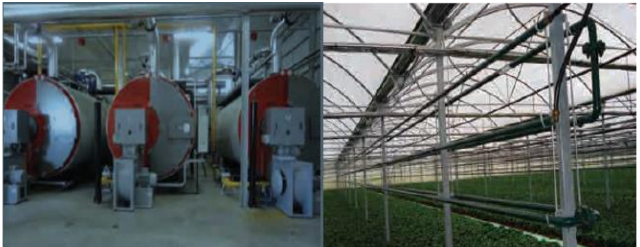
Figure I- 10:Chaudière centrale (à gauche) et tuyaux de chauffage pour dissiper la chaleur produite (à droite)
