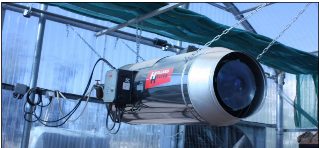
Figure 32 : Système du chauffage (Original).
