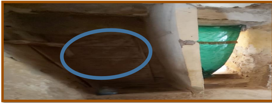
الصورة 11: الرطوبة بسبب بفعل التسرب المياه المصدر: الكاتب
