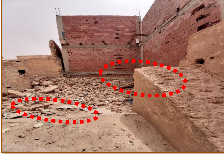
الصورة 7: تبين الأضرار على مستوى سطح المنزل المصدر: الكاتب
