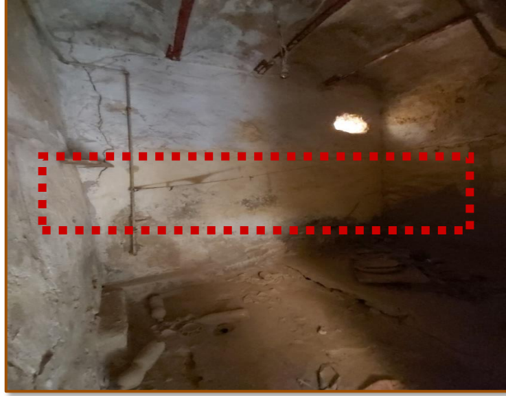
الصورة 5: التآكل لتسرب الرطوبة بسبب المياه المصدر: الكاتب
