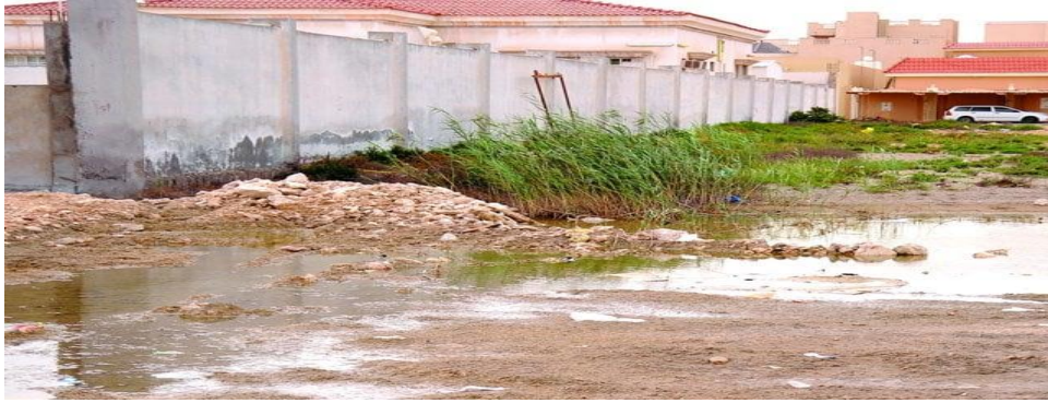
الشكل 5.2: توضح ارتفاع منسوب المياه جوفية وأثرها على المبنى.
