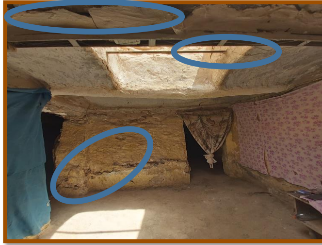
الصورة 13: الشق أفقي والتآكل بسبب الرطوبة وشيخوخة المواد المصدر: الكاتب
