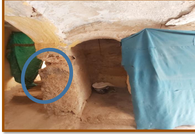
الصورة 12: التآكل بسبب ارتفاع الرطوبة والأملاح في الجدار. المصدر: الكاتب
