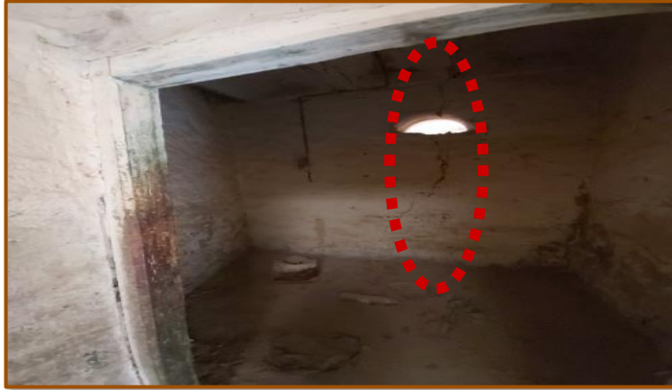
الصورة 3: شقوق عمودية بسبب أحمال السقف وشيخوخة المواد المصدر: الكاتب
