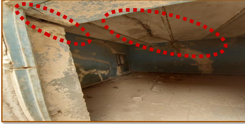
الصورة 2: شقوق أفقية بسبب شيخوخة المواد وأحمال السقف. المصدر: الكاتب
