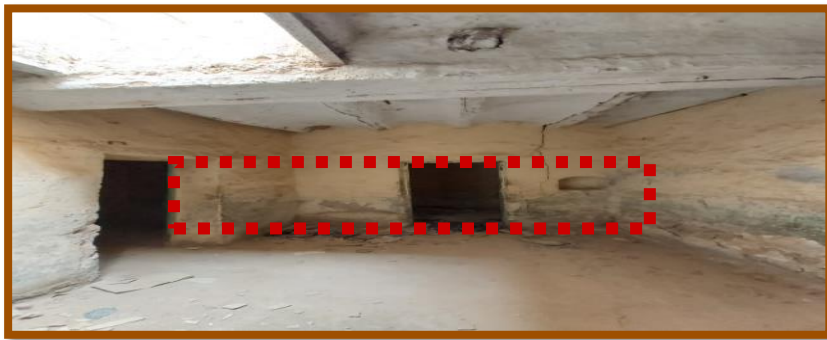
الصورة 4 :التآكل بسبب شيخوخة المواد المصدر :الكاتب
