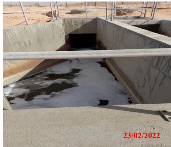
Photos 8. Sortie des eaux épurées
