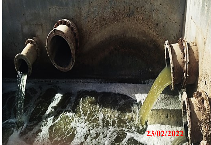
Photo 3. Entrée des eaux usées à la station (bassin de dégazage)
