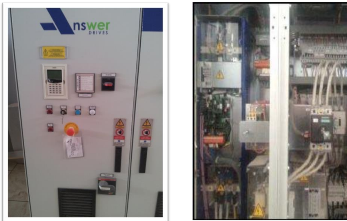
Figure III.11 : Onduleur de central PV Ghardaïa
