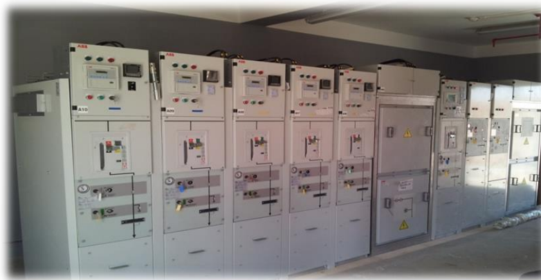
Figure III.14 : Poste d'évacuation moyen tension
