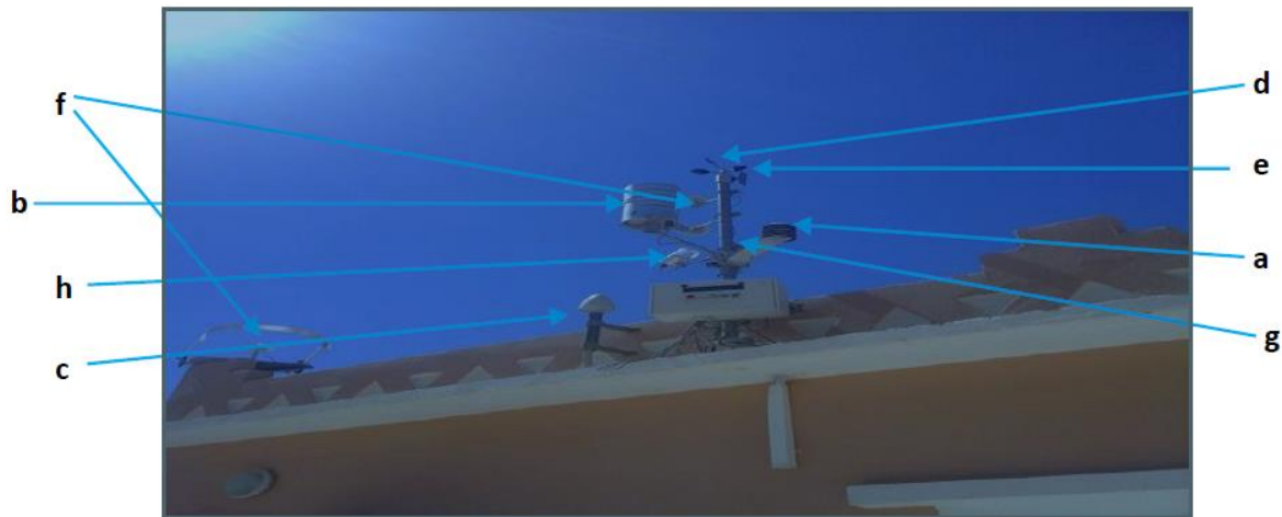
Figure III.15 : Station météorologique installée dans la centrale PV d'Oued Nechou Ghardaïa
