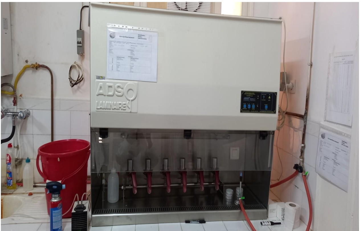
Photo08 : rampe de filtration originale
