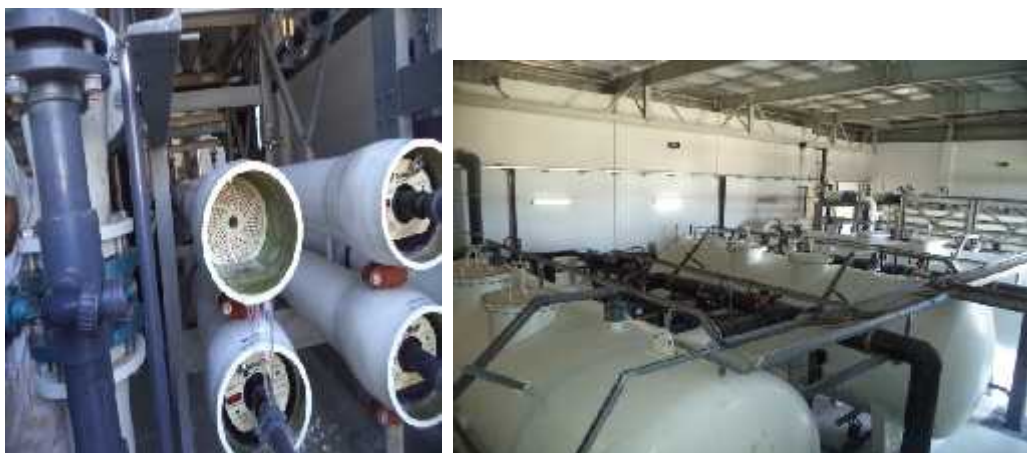
Figure N° 59 : Station de filtration d'El GARA (Ouargla)
