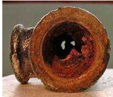
Figure N°12 : Type de corrosion galvanique (BERTOSSA, 2011).
