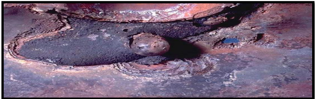
Figure N° II.4 : Corrosion galvanique au niveau d'une zone de brasage entre la brasure Cu-P et le tube en cuivre.
