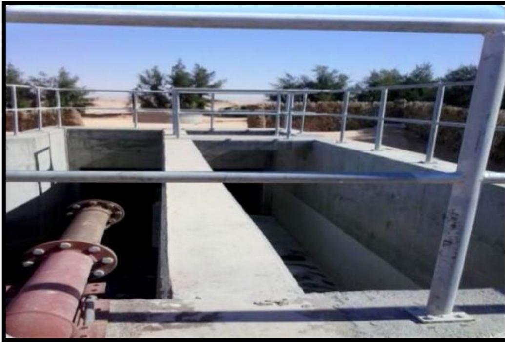
Figure 3.8 : Canales de transport des eaux usées (à gauche) et des eaux de drainage (à droite).
