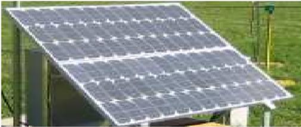
Fig 5 : panneau de solaire.
