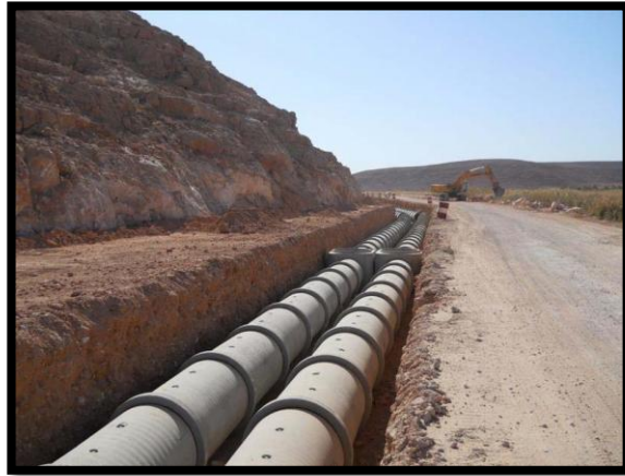
Photo III.1 : Collecteurs d'amenée des eaux usées.
