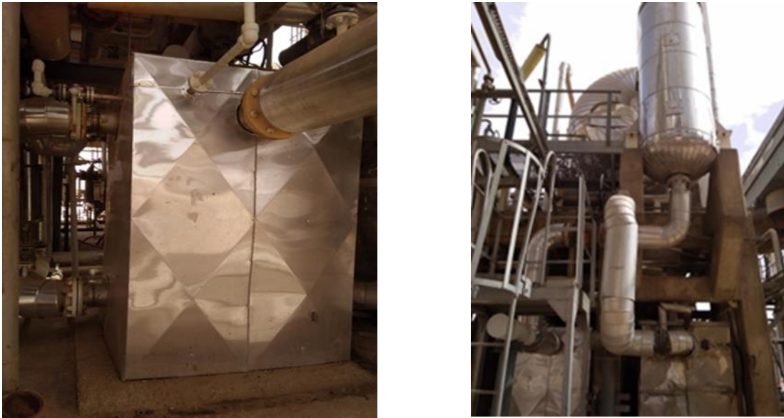
Figure II-12 : Vue générale Echangeur a plaque
