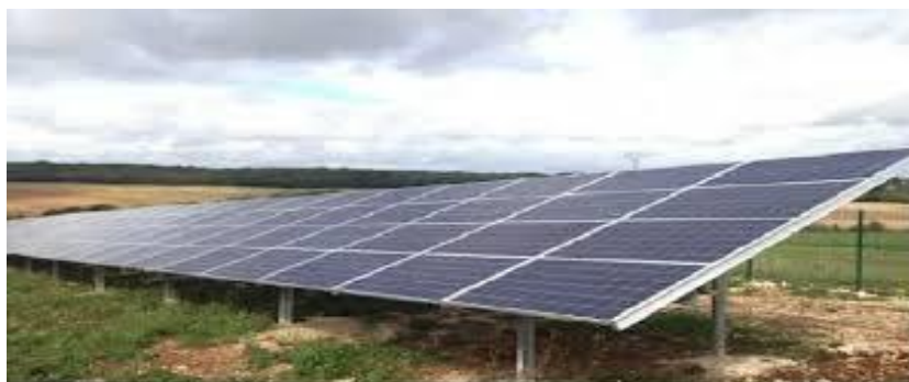
Figure II.2 : Vue du générateur photovoltaïque [13].
