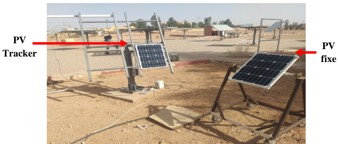
Figure III.36 : Prototype d'un PV fixe et d'un Tracker installé au niveau de l'URAER – Ghardaia-
