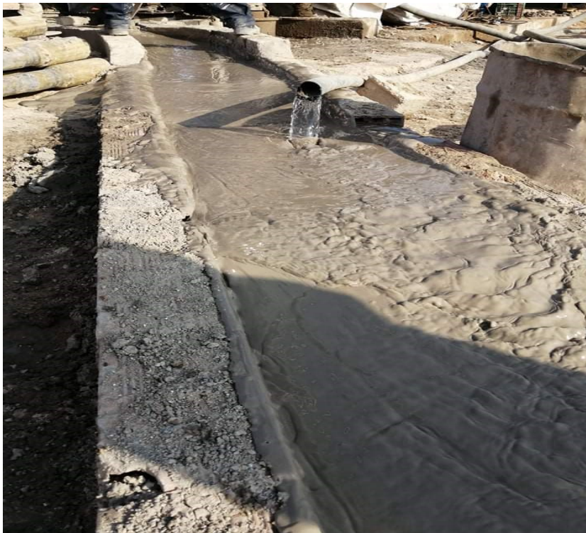
Figure III.4 : Rigoles d'évacuation de la boue.
