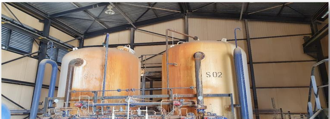
Figure III.15 Filtre d'eau S/01.02
