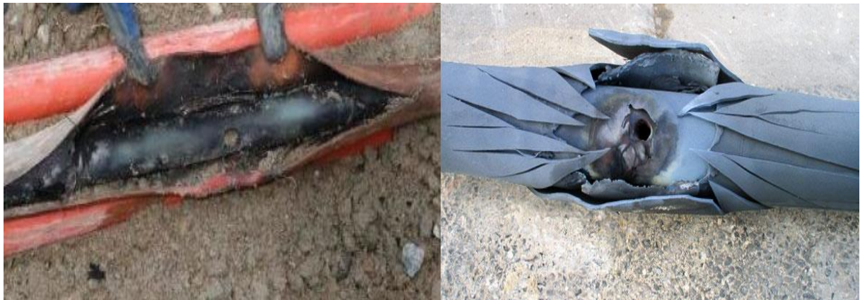
Figure I.11 : Exemple de claquage d'un câble électrique [23]
