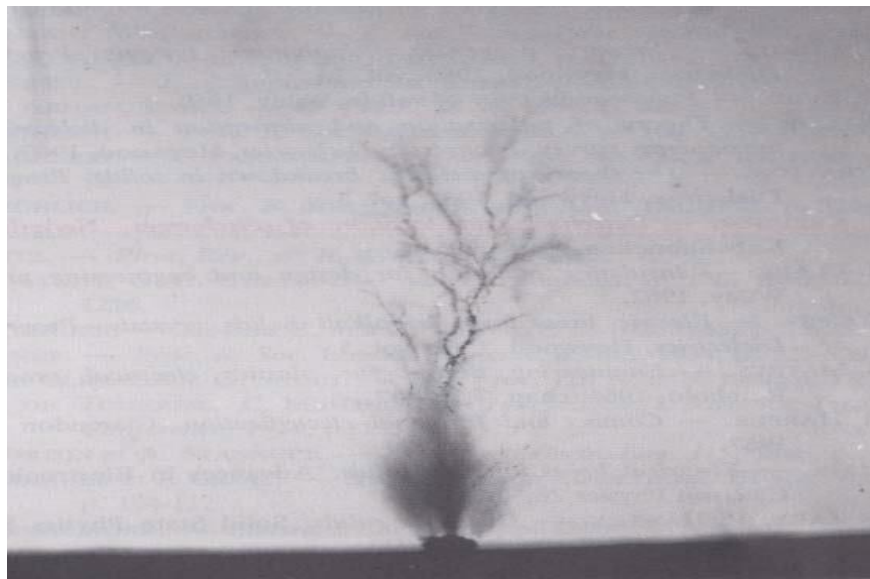
Figure I.10 : Arborescence électrique observée dans un câble HT [1]
