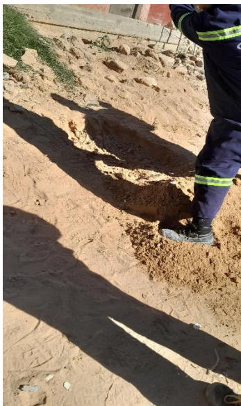
Figure II.1 : regard enterré par sable.
