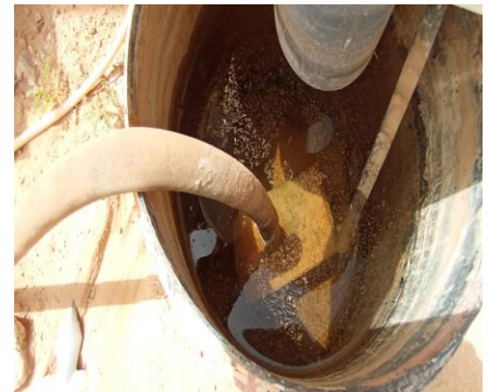
Fig 23 : Pompe à eau à l'intérieur du réservoir
