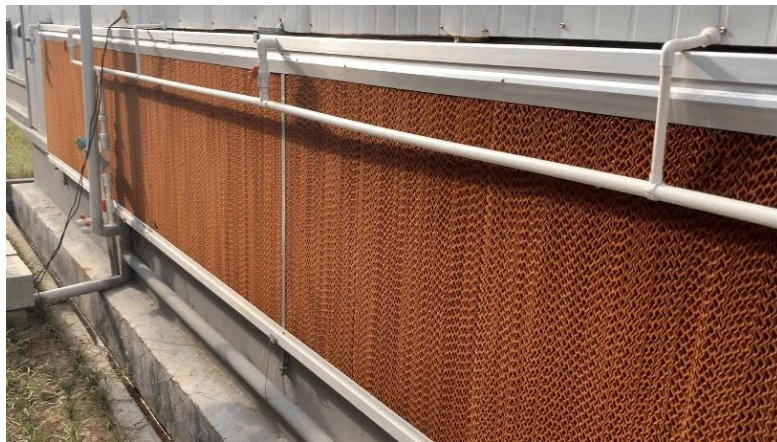
Fig. 5 : Coussinets de refroidissement [15].
