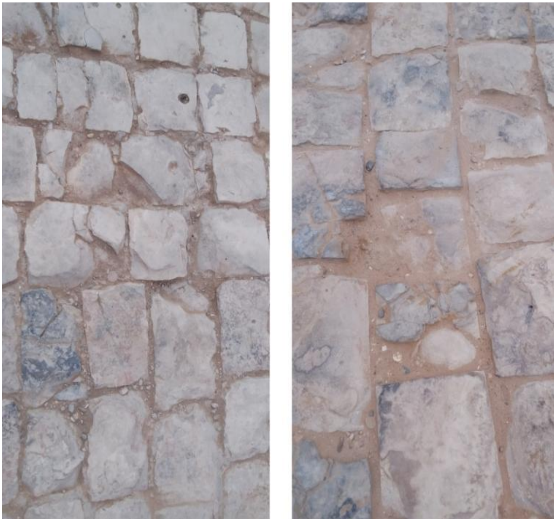
Photo 5.9 : Eclatement des pierres. Source : Auteurs
