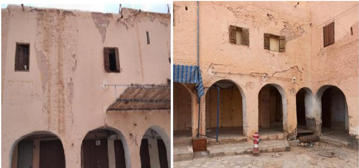
Photo 5.24 : Dégradation d'une partie des crépiages. Source : Auteurs
