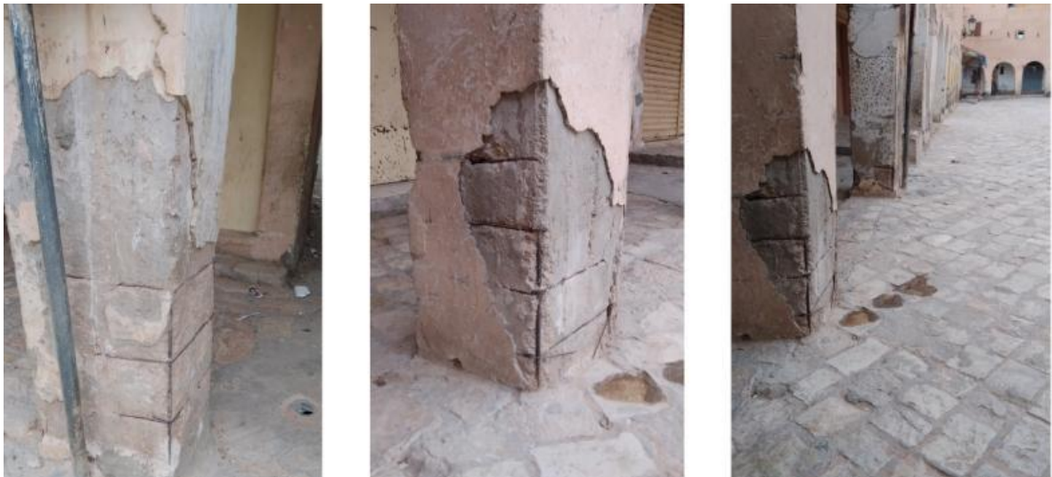
Photo 5.22 : Dommages au crépissage des colonnes restaurées Source : Auteurs
