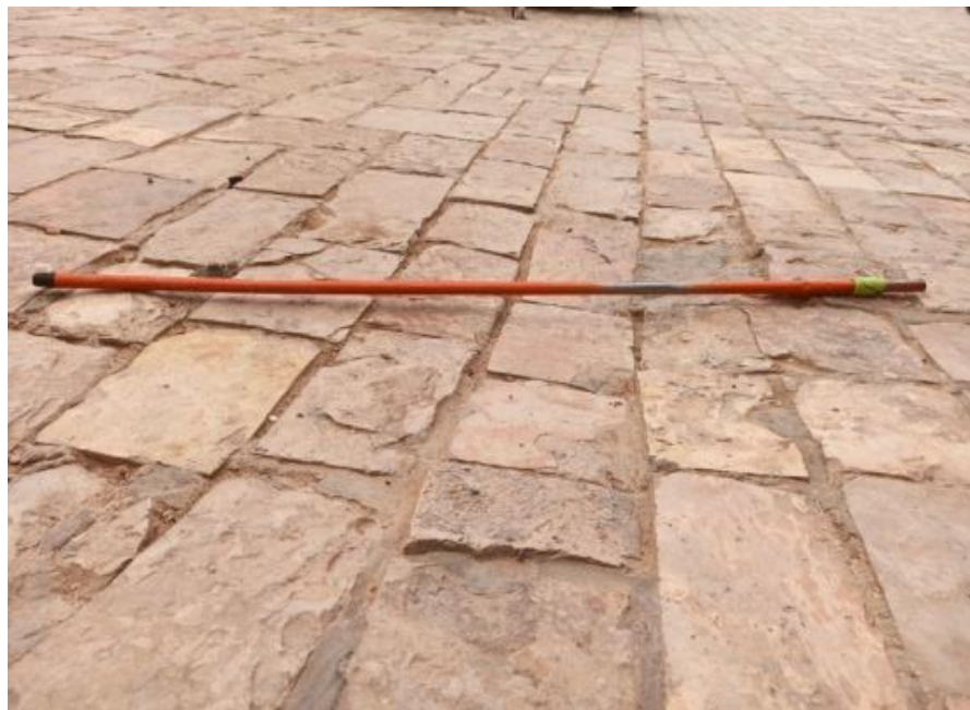
Photo 5.7: Déformation locale. Source : Auteurs
