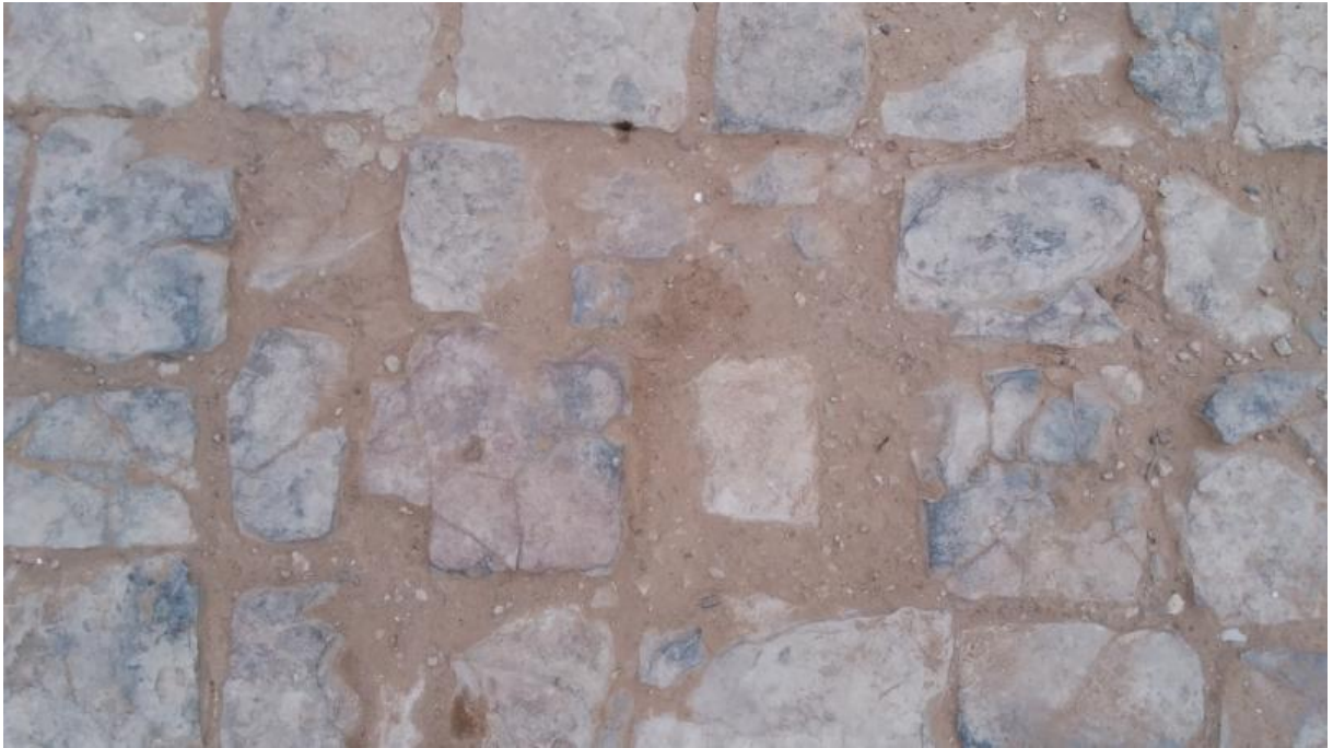
Photo 5.10 : Désintégration des pierres. Source : Auteurs
