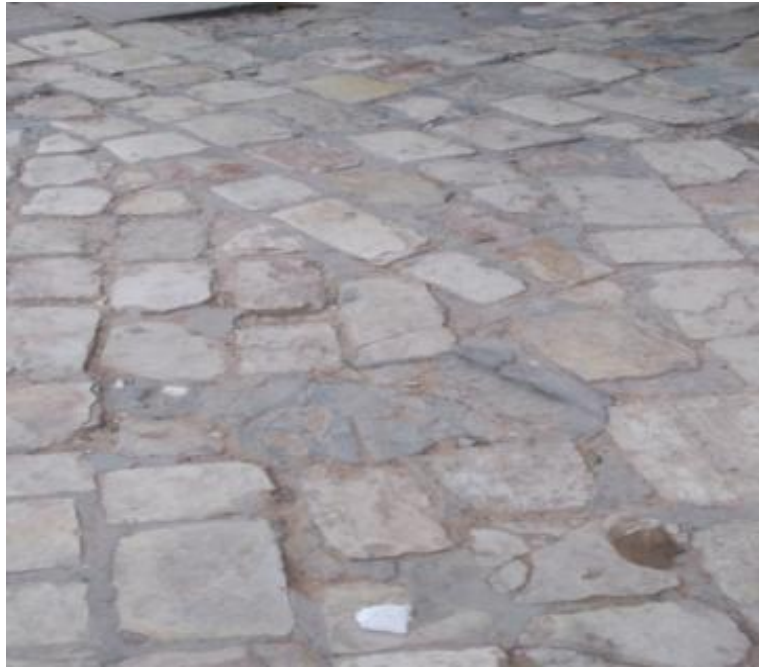
Photo 5.1 : Perte de cohésion structurelle due à une finition non soignée autour des points singuliers. Source : Auteurs
