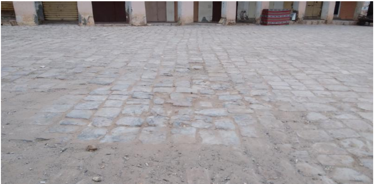
Photo 5.11 : Eclatement de pierres. Source : Auteurs
