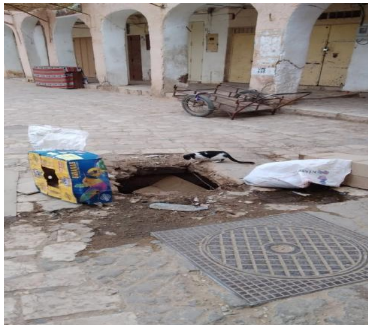
Photo 5.16 : Avaloir en état dégradé. Source : Auteurs
