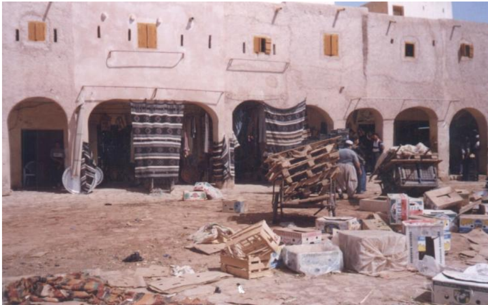
Photo 2.8 : Achèvement des travaux de traitement de la façade nord-ouest de la place du marché. Source : [4]
