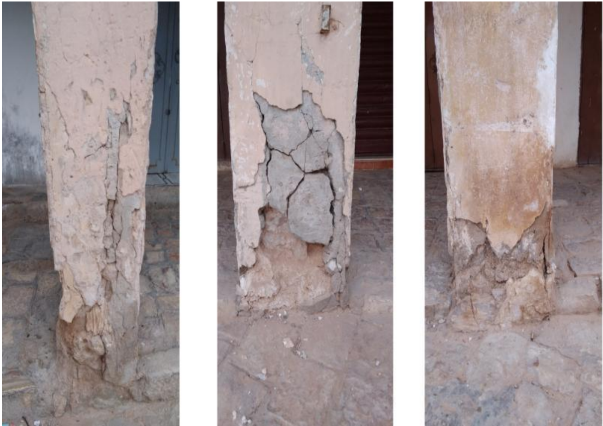
Photo 5.20 : Dégradation le soubassement des colonnes des façades. Source : Auteurs
