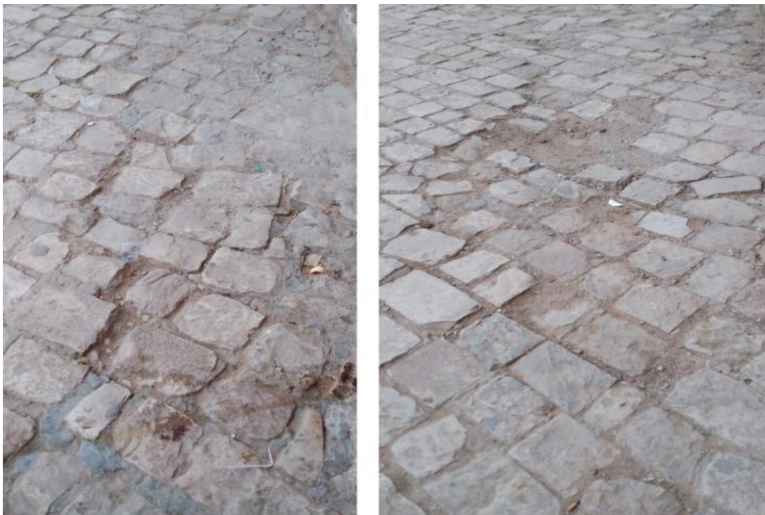
Photo 5.2: perte de cohésion structurelle due à un appareillage inadapté. Source : Auteurs
