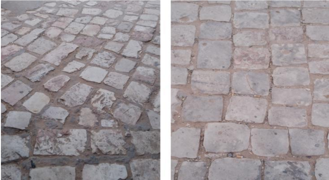
Photo 5.3 : Perte de cohésion structurelle du pavé due à des joints trop larges, à des joints trop étroits. Source : Auteurs
