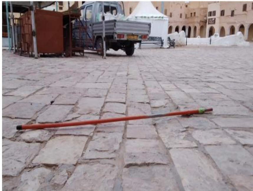
Photo 5.8 : Déformations locales dues à une exécution peu soignée Source : Auteurs
