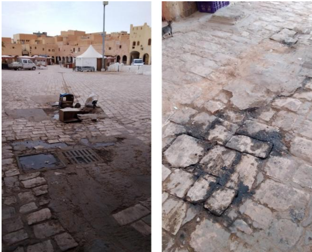
Photo 5.15 : Dégradations résultant d'un mauvais d'évacuation. Source : Auteurs
