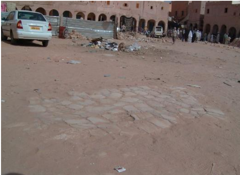
Photo 2.13 : Etat de pavés avant les travaux de réhabilitation (partie nord) Source : [4]
