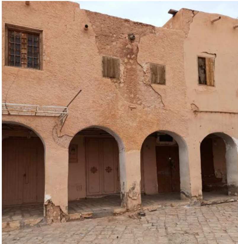
Photo 5.23 : Dégradation de la chape de protection au dessus de mur d'acrotère, Cela a entraîné la endommagée d'une partie du crépiage. Source : Auteurs
