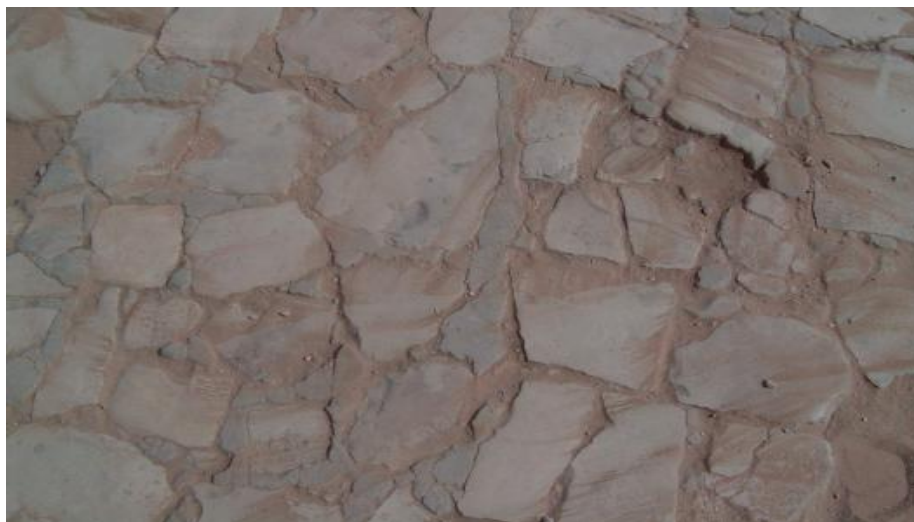
Photo 2.12 : Etat de pavés avant les travaux de réhabilitation (partie Sud). Source : [4]
