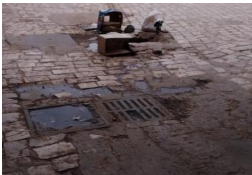
Photo 5.14 : L'avaloir est bouché. Source : Auteurs
