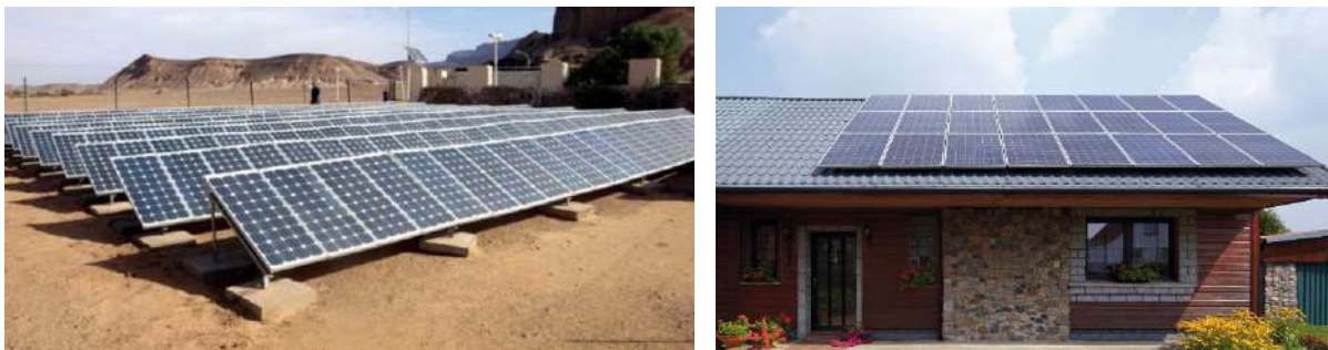
Figure 1.4 : Exemples d'installations photovoltaïques, a : Projet de centrale PV à Beni-Ounif, b : Système PV intégré à une construction
