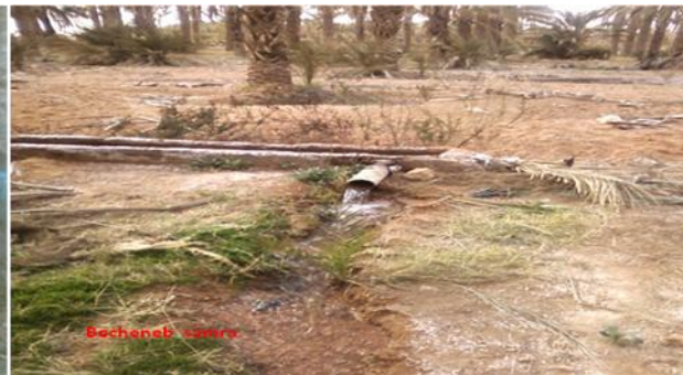
Phot 06: réseau d'irrigation pas complète.
