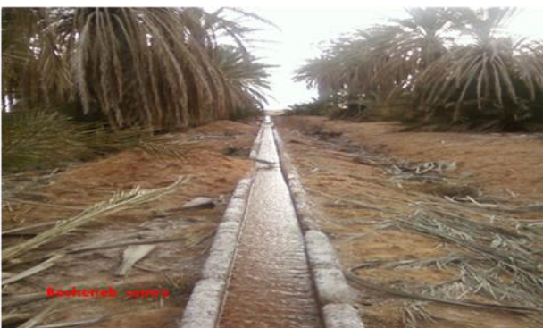
Phot 07: réseau de drainage pas nettoie.
