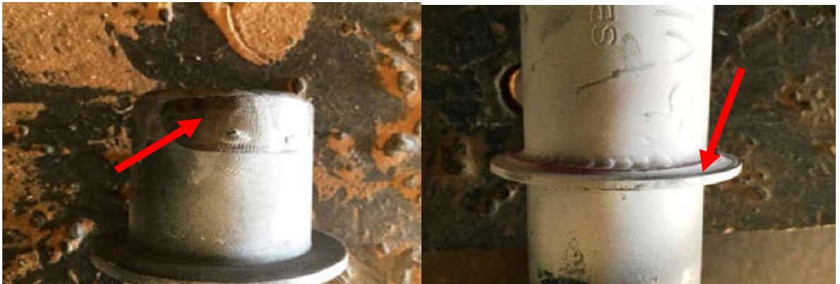
Figure IV.4 : Usure des tubes d'interconnexion
