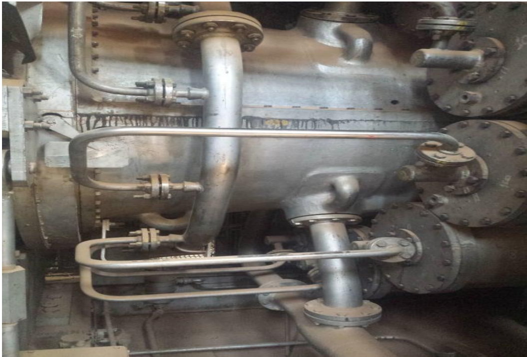
Figure II.3 : Section de combustion vue externe
