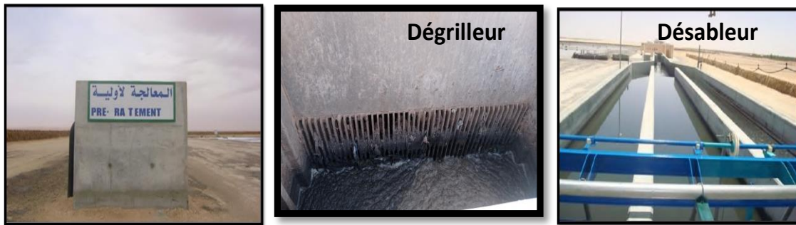
Figure 16 : Phases de prétraitement dans la STEP de Saïd Otba (STEP, 2020)
