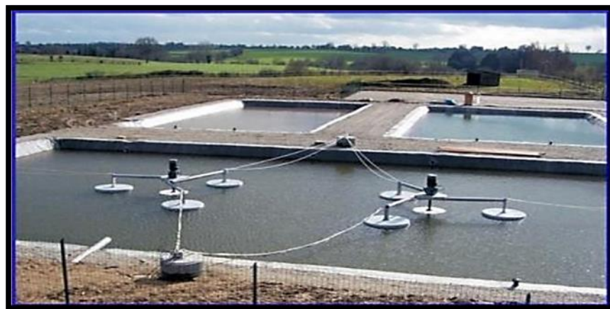
Figure 2 : Photo de bassins de lagunage aéré (Hakima El Haité, 2010)
