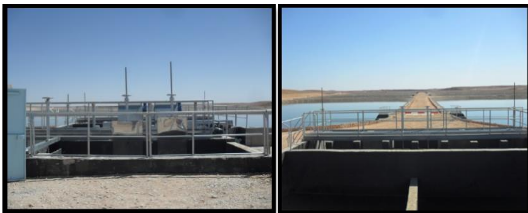
Figure 10 : Dégrillage/dessablage. 2 : Répartiteurs principales vers les bassins primaires et secondaires. (STEP, 2021)
