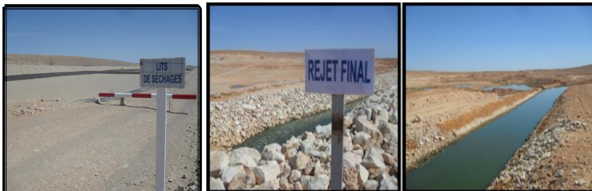
Figure 12 : Lits de séchage des boues et le rejet final de la STEP vers oued Noumer.
