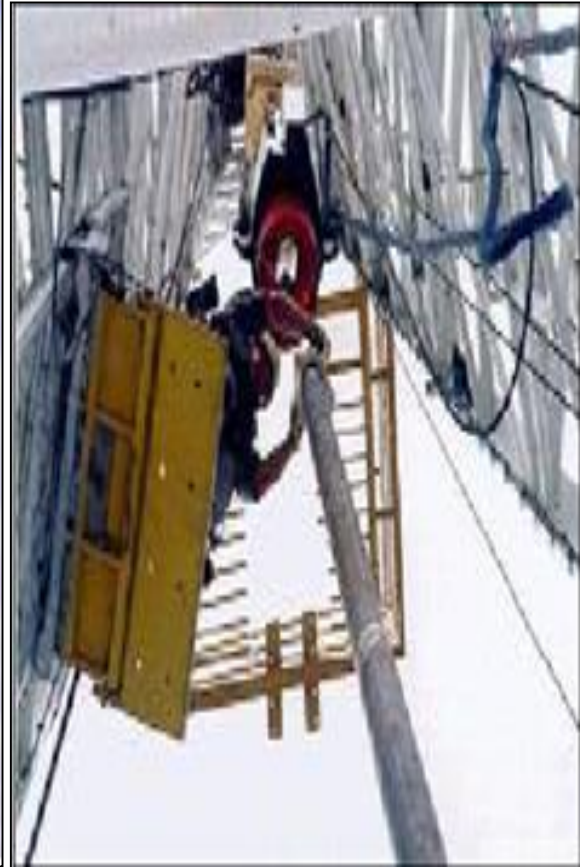
Figure 21 : Passerelle de tubage.
