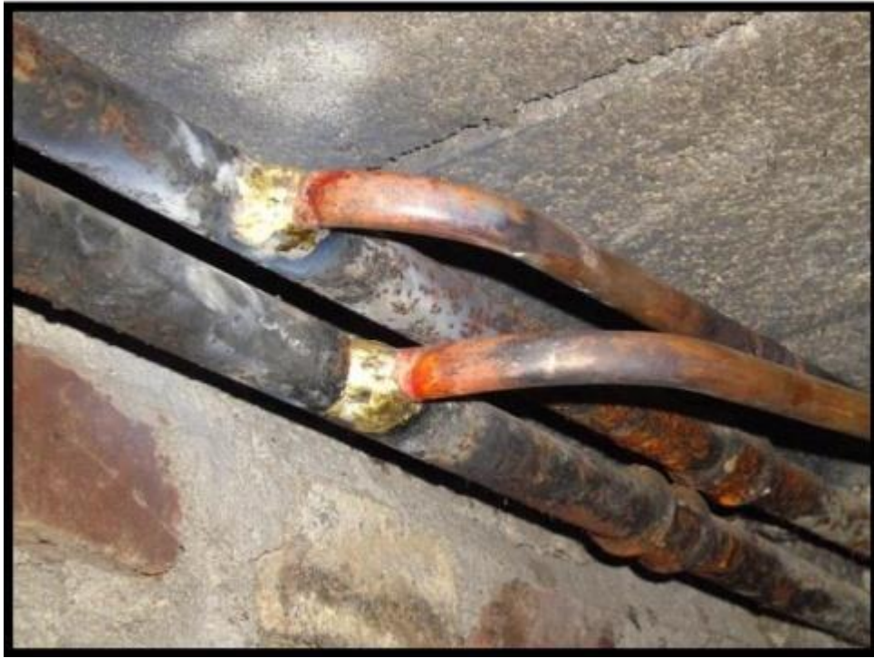
Figure 06 : Corrosion chimique : Cuivre et acier noir dans une installation
