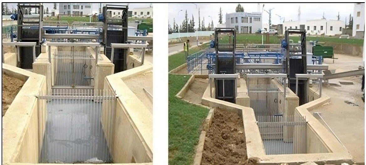
Photos 05: une grille à nettoyage manuel. [5]
