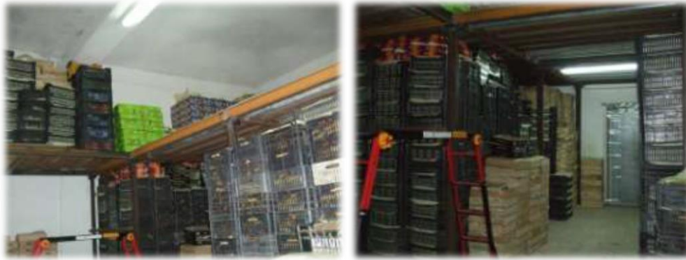
Figure 34 : Intérieur d'une chambre froide (Bensayah, 2014).
