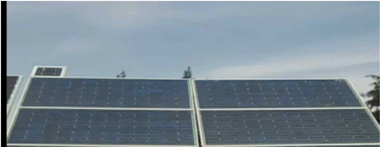
Figure 5.3 Le générateur photovoltaïque du banc d'essai de pompage [au sien de l'UREAR]
