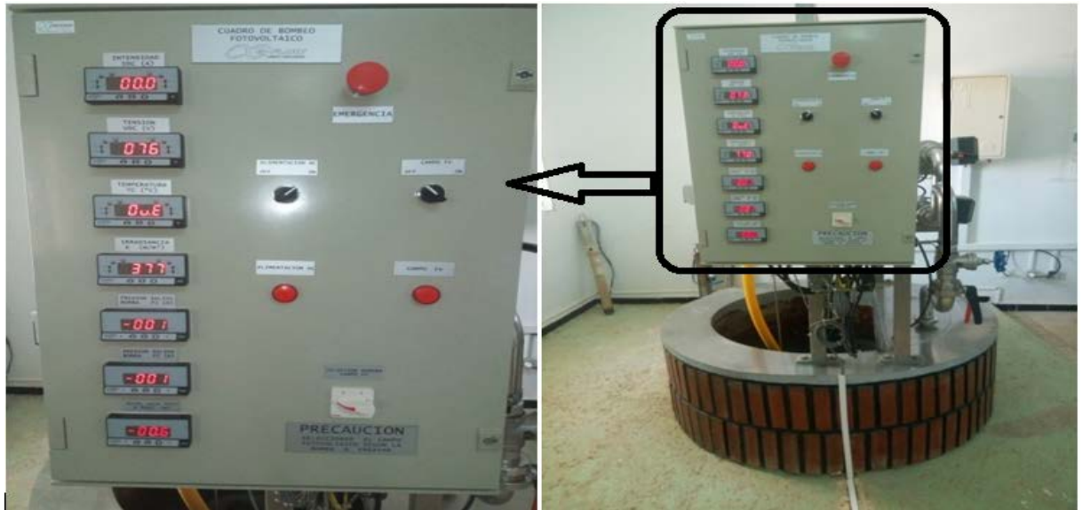
Figure 5.5 Armoire de puits
