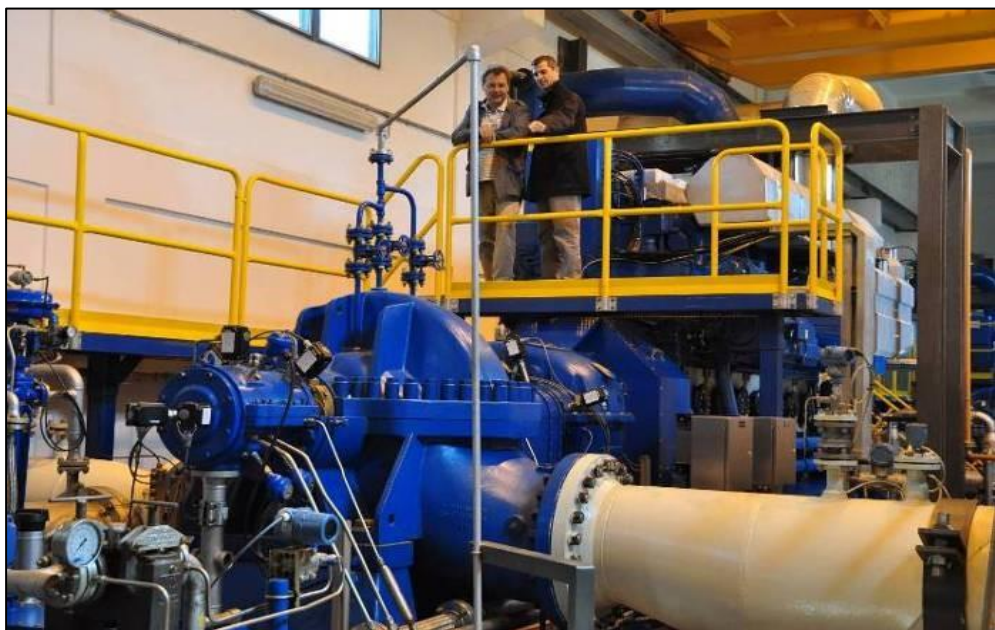
Photo IV.3 : Salle des pompes.
