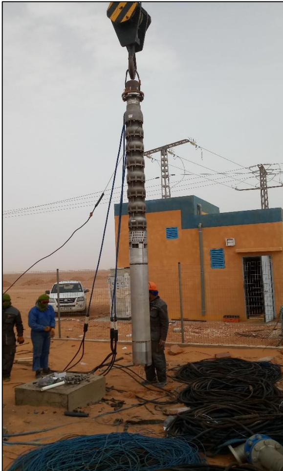
Annexe.13. la pompe immergée
