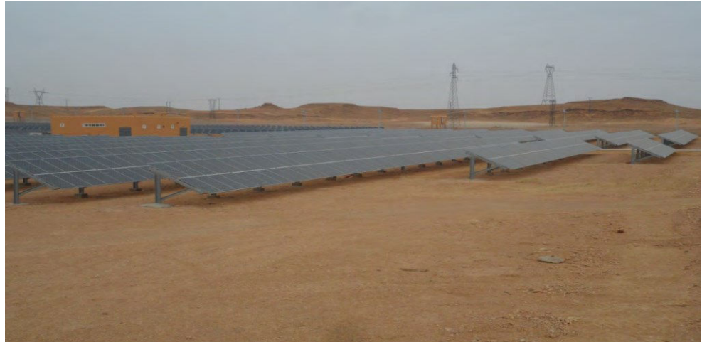
Figure IV.6 : Sous champs(5) : Technologie Monocristallin sur structure fixe.[53]
