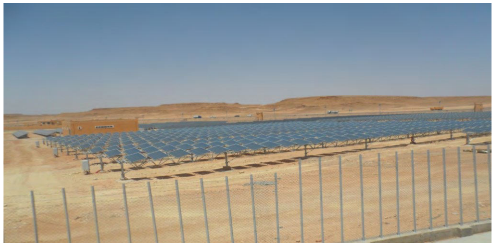
Figure IV.3 : Sous champs (2) : Technologie Polycristallin sur structure motorisée.[53]
