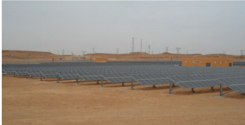
Figure IV.8 : Sous champs (7) : Technologie Monocristallin sur structure fixe.[53]
