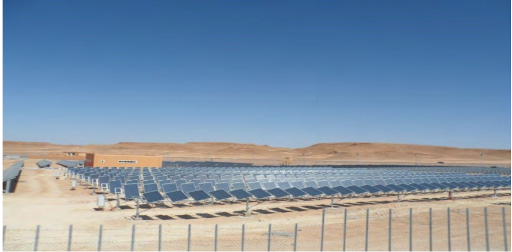
Figure IV.2 : Sous champs (1) : Technologie Monocristallin sur structure motorisée.[53]
