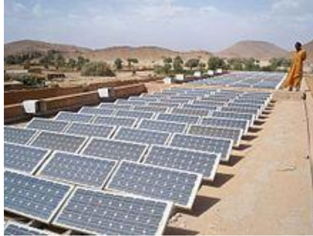
Figure 12: Énergie solaire en Algérie
