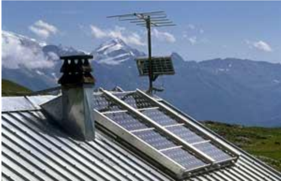
Figure 2 : L'utilisation des panneaux photovoltaïques
