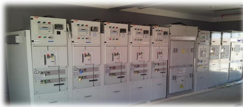
Figure IV.14 : Poste d'évacuation moyen tension – HTA [27]
