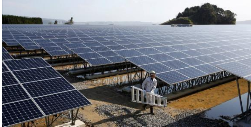
Figure.I.26 : Centrale de NANAŌ (JAPON) [14].
