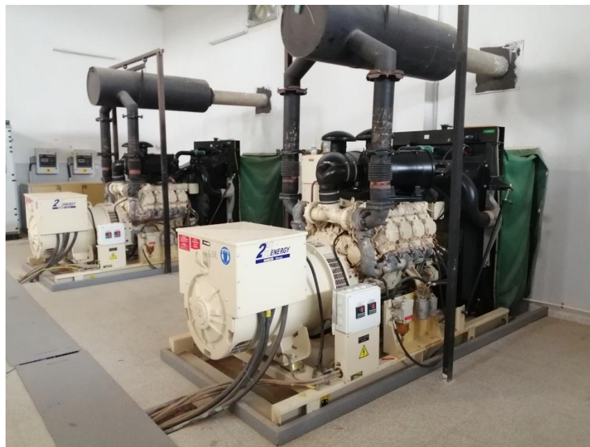
Figure II.1 : groupe électrogène 2H ENERGY
