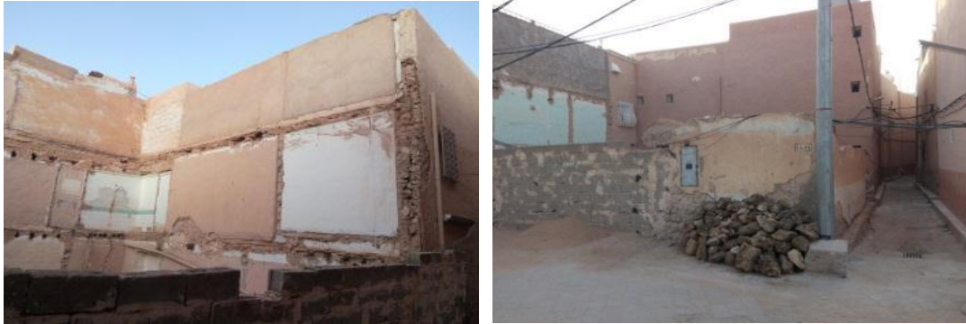
Figure 54: maison effondré. Pris par les étudiant.
