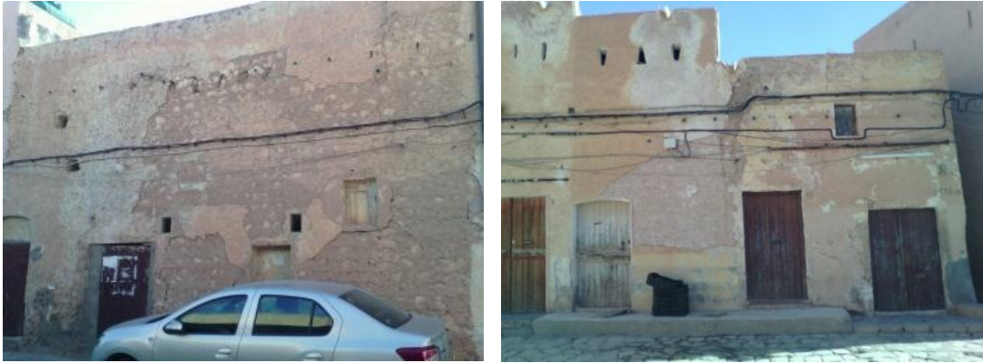
Figure 57: enduit détérioré. Pris par les étudiants
