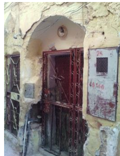
Figure 66: fuite au niveau du compteur.
