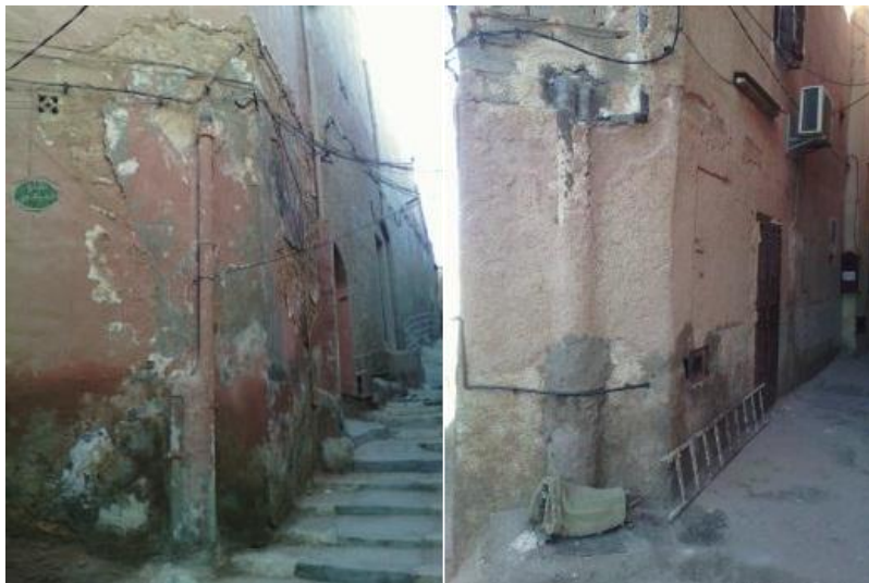
Figure 65: humidité sur la façade. Pris par les étudiants
