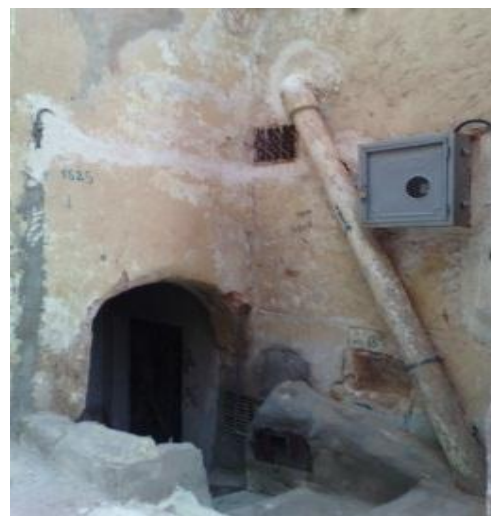
Figure 69:Compteur de gaz
