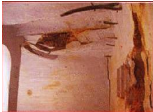
Figure 70: Déformation des plancher [22].
