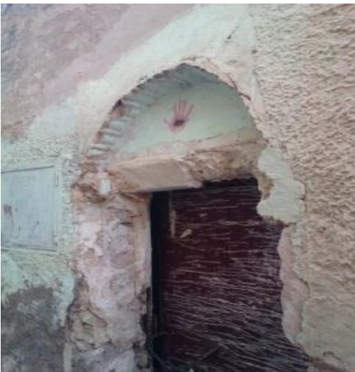
Figure 59: Dégradatio éléments décoratifs.
