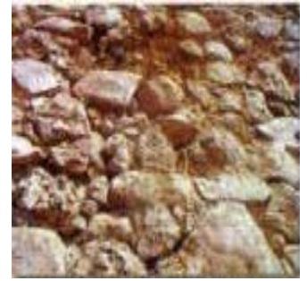
Figure74:Détérioration de Mur [22].
