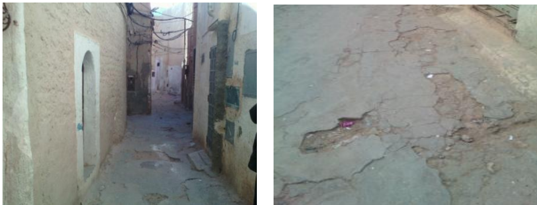
Figure 56: pavage dégradé. Pris par les étudiants
