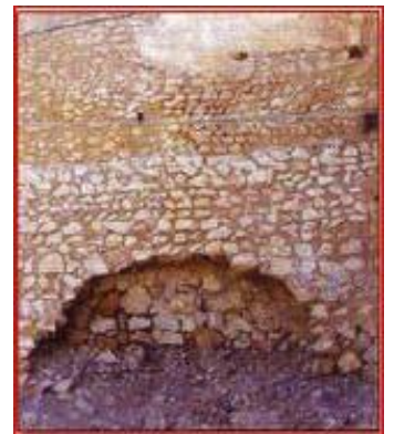
Figure 79: détérioration de mur [22].
