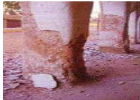
Figure 71: Dégradation de la mortiers [22].
