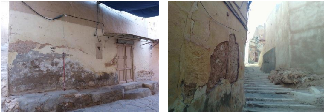
Figure 55: la dégradation de soubassement. Pris par les étudiants
