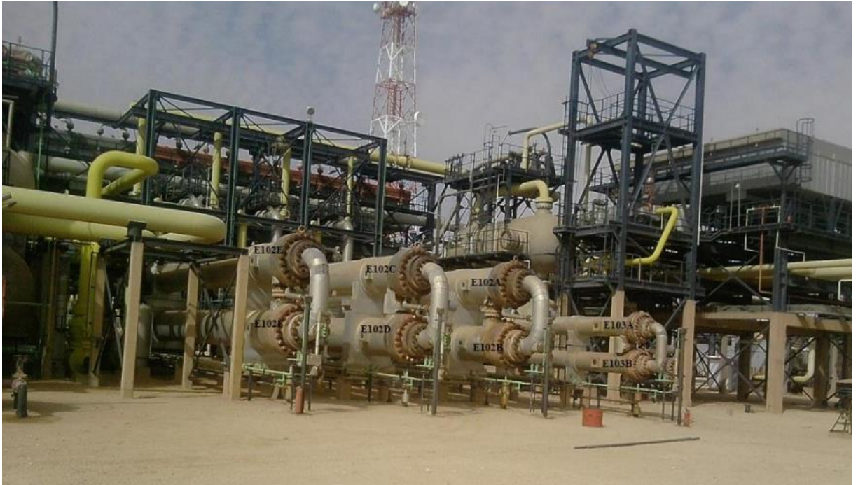
Figure III.8: échangeur de chaleur E102 A/F au niveau de module IV.
