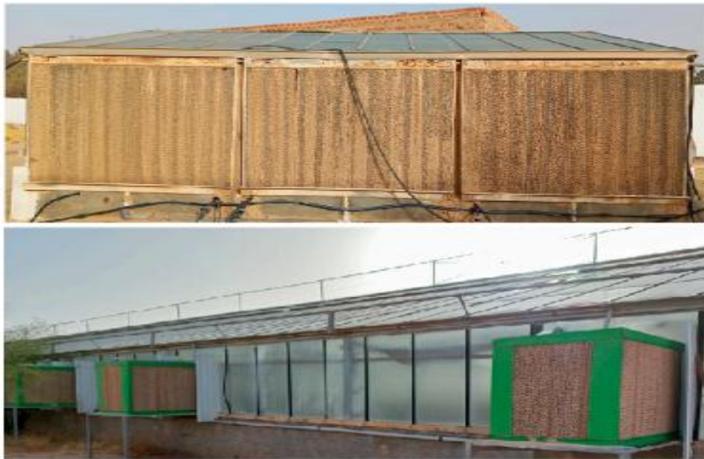
Fig. II.6 :Systèmes de refroidissement par ventilateur et tampon pour les serres de l'Institut des régions arides
