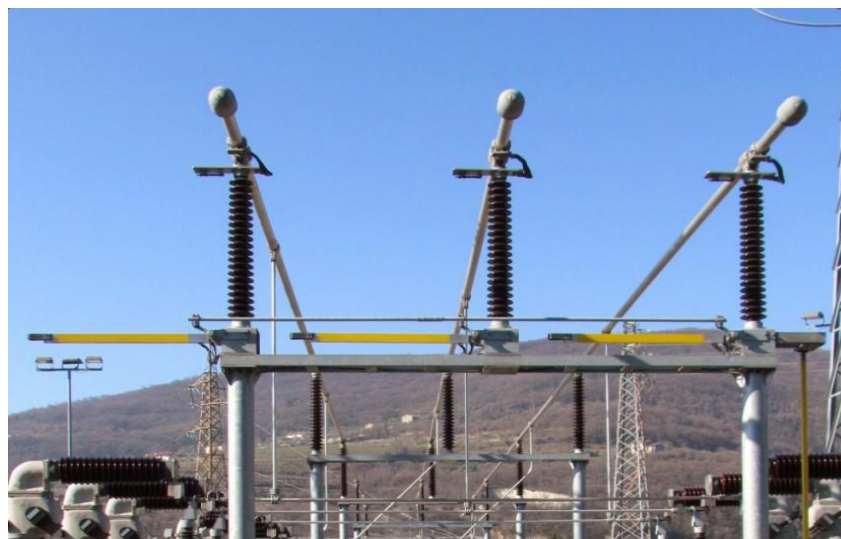
Figure II.5 : Sectionneur de mise à la terre
