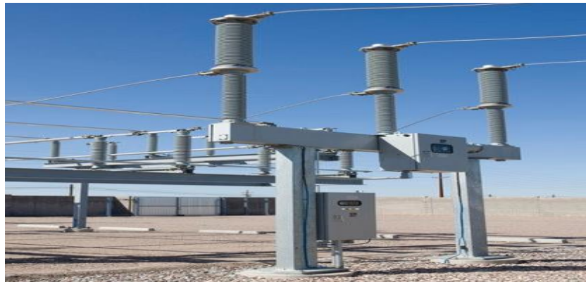
Figure II.6 : Disjoncteur haute tension
