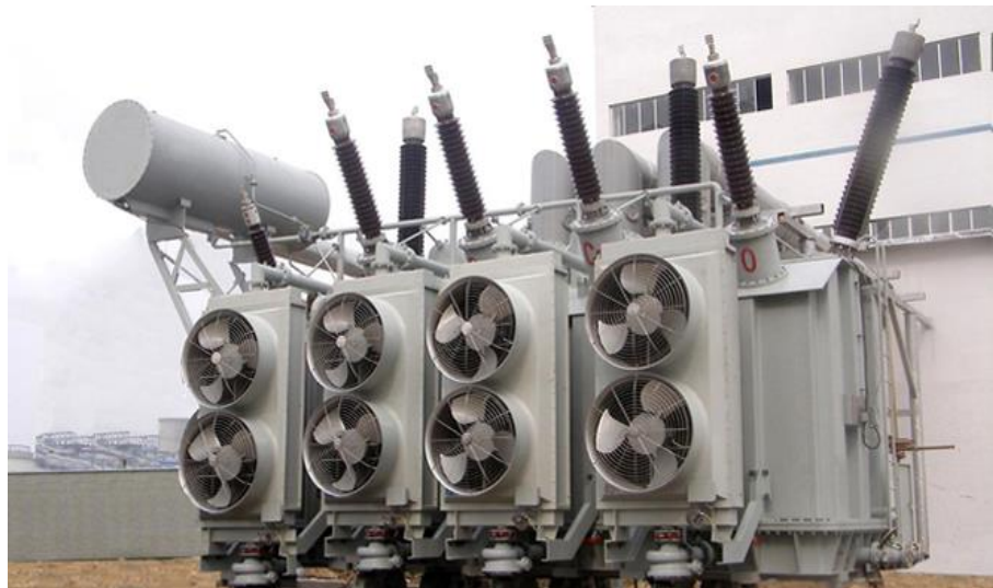
Figure II.24 : Refroidissement à l'aide des ventilateurs
