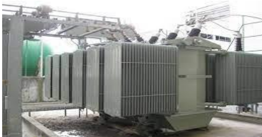
Figure II.23 : Les radiateurs de refroidissement d'huile
