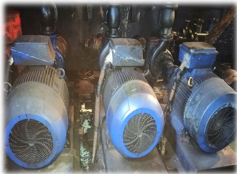
FIG III. 4. Pompes de remplissage
