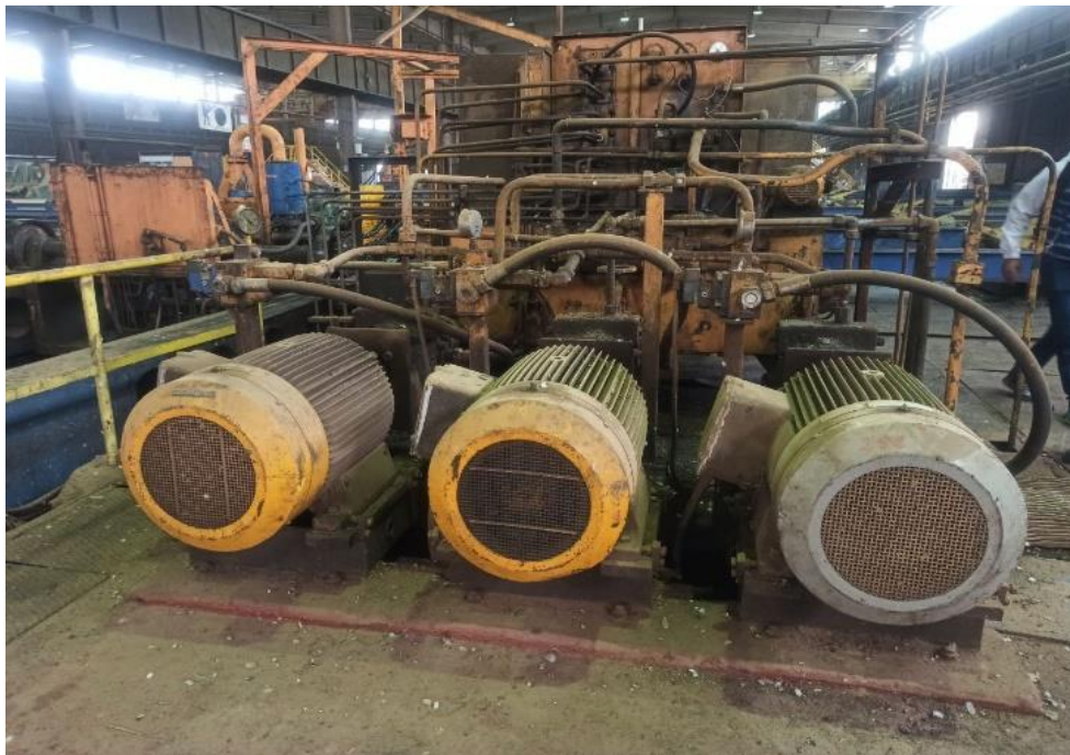
FIG III. 6. Pompes principales pour les vérins et Pompe de circulation
