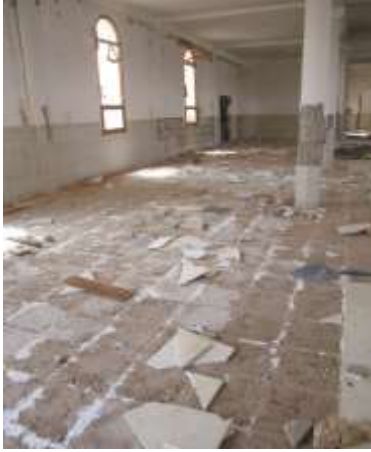
صورة (6.5): البلاط داخل البنية مهترئ.
