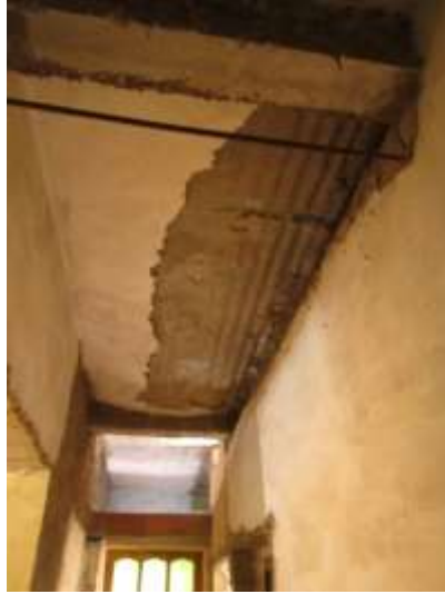
صورة رقم (22.2): سقوط تلبيس السقف بسبب سمكه الكبير. مصدر: من تصوير الباحثين، منزل إحدى الباحثين.
