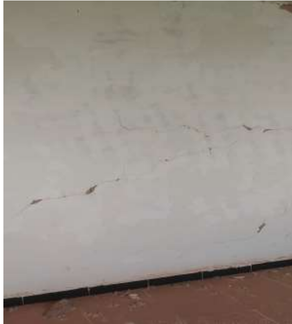
صورة (21.5): شق أفقي في منتصف الجدار.
