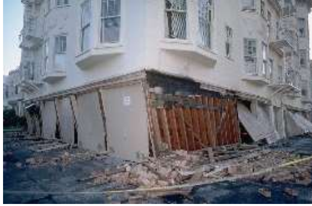
الصورة (1.2): هبوط كبير متساوي لمبنى.
