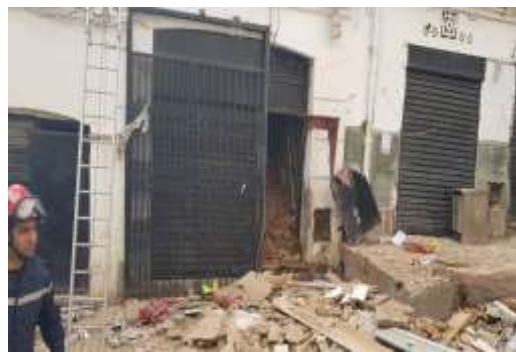
صورة (5.2): انهيار جزئي لبناية قديمة. مصدر: المغرب الأوسط (18:07 2020/12/28)، انهيار جزئي لبناية قديمة في حي القصبه، المغرب الأوسط، العدد 4040.
