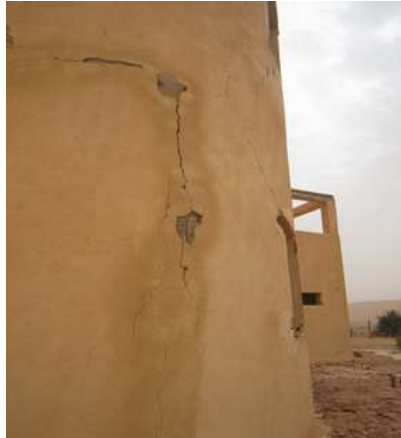
صورة (7.5): تسرب مياه الأمطار عبر جدار درج البنية وشقوق مصاحبة له.
