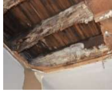
صورة (17.2): تعفن سقف خشبي.
