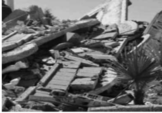
صورة (6.2): انهيار كلي بسبب الزلزال.
