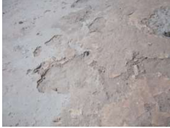
صورة (24.2): تآكل خرسانة سطح منزل بفعل الامطار والرياح. مصدر: من تصوير الباحثين، منزل إحدى الباحثين.
