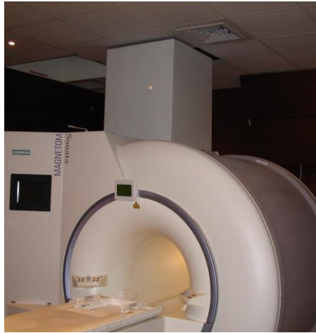
FIGURE 3.10. Cheminée du tube de Quench
