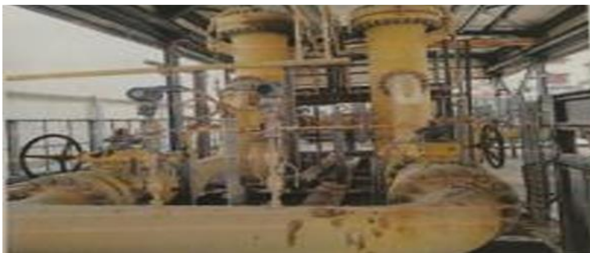
Figure 2.12 : Poste gaz de l'unité.
