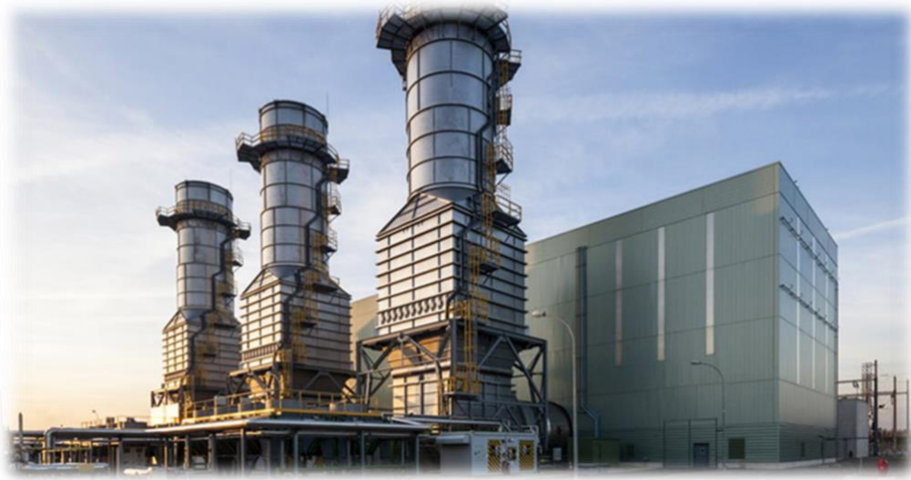
Figure 1.6 : centrale à gaz
