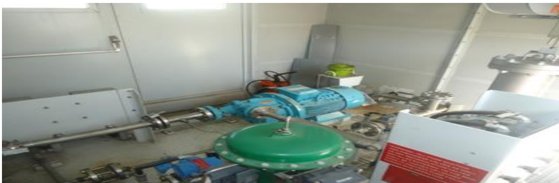
Figure 51 : Pompe d'injection d'eau déminéralisée [7]
