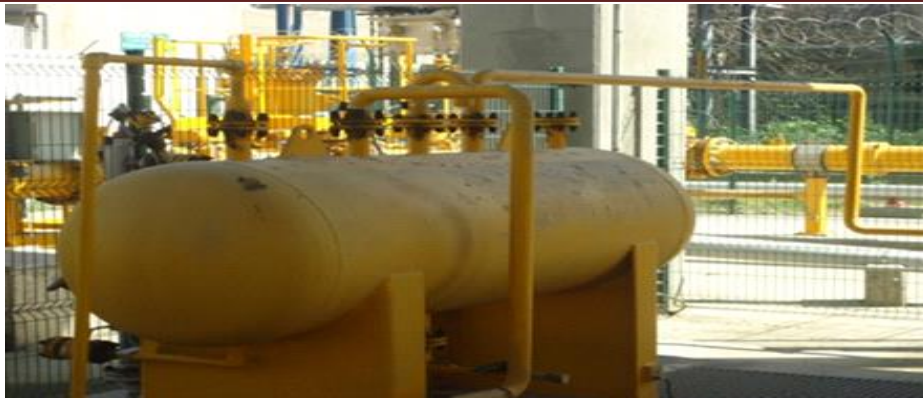
Figure 45 : Réservoir à condensats [7]
