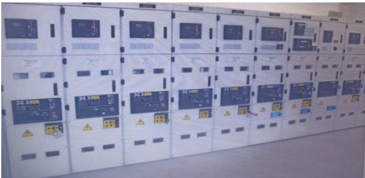
Figure 54 : Tableau MT 6,6kV 00BBA10 [15]
